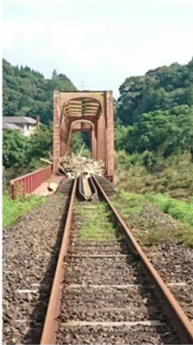
鉄橋の上まで氾濫時のごみが残る
