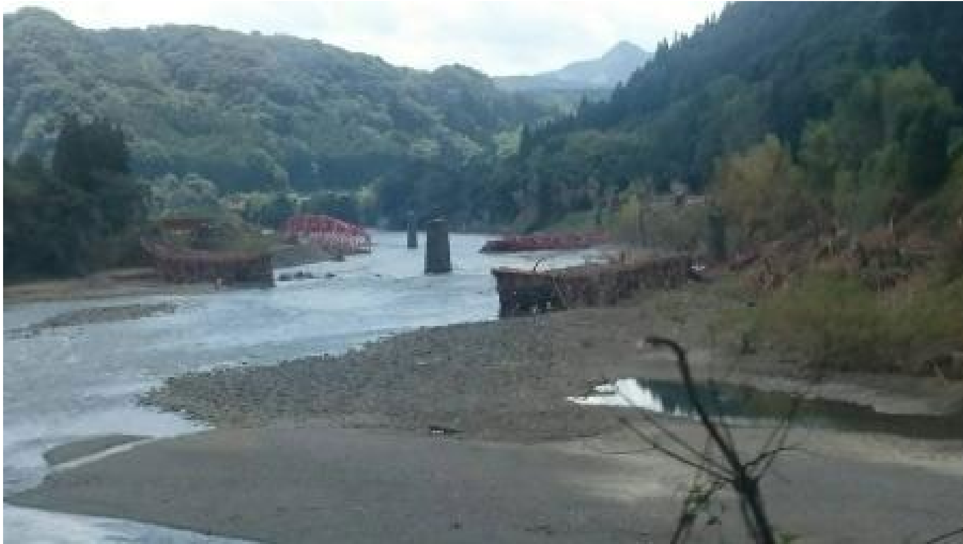
鉄道の橋桁が流されてる
