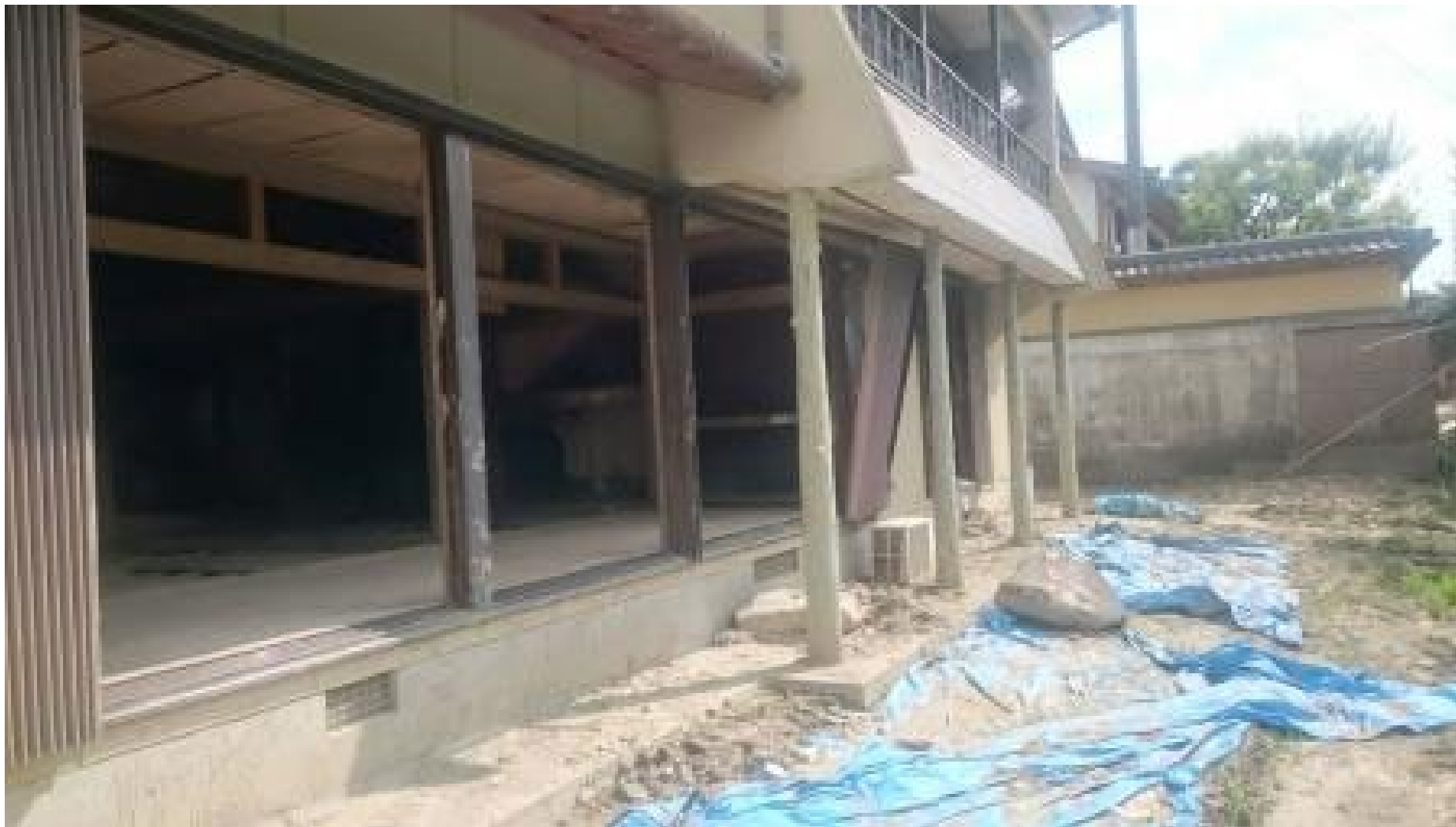
球磨川の氾濫で2階まで浸水
